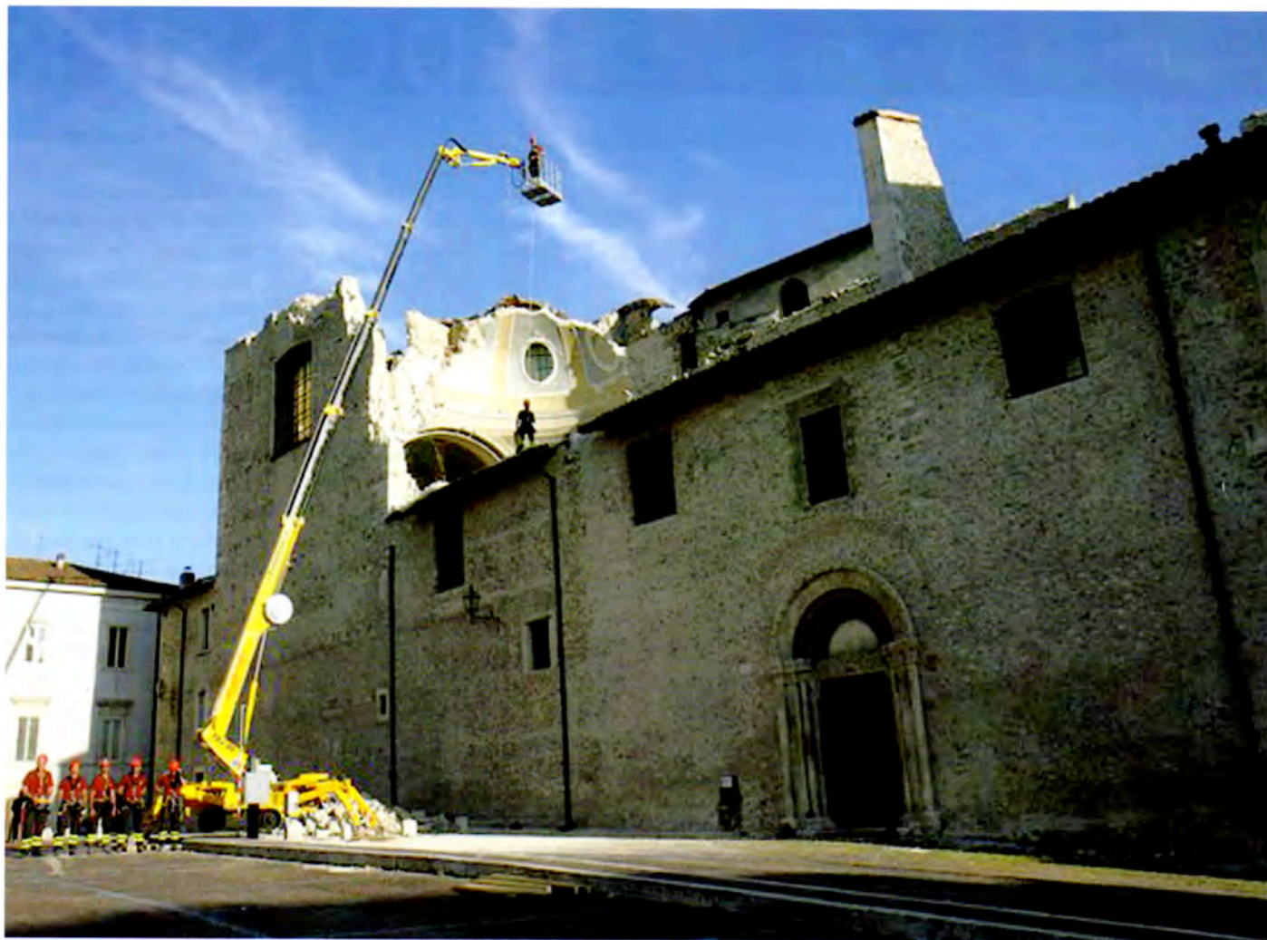
Un palazzo del centro storico dell'Aquila danneggiato dal sisma del 6 aprile 2009. Foto: www.kremlin.ru .
